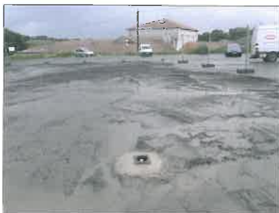
Mise en place du piézair PzR
