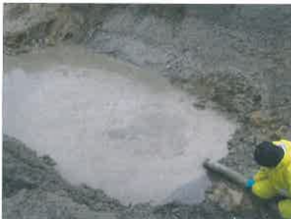
Récupération des eaux hydrocarbonées par SANITRA Fourrier
