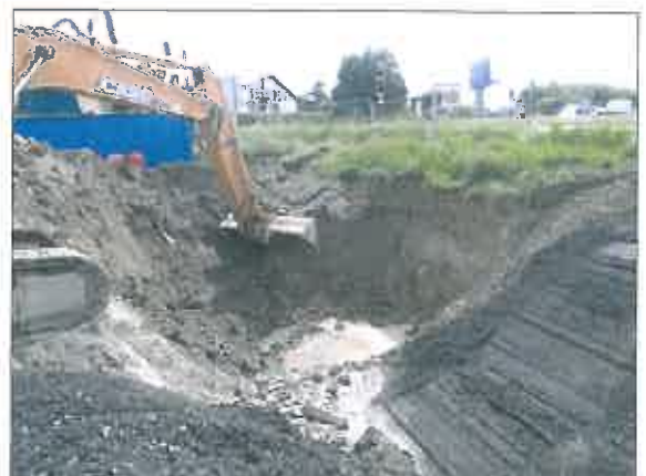
Excavation des terres impactées en fond et sur le flanc Nord de la fouille de l'ancien réservoir enterrés de 80 m 3 GO/GNR
