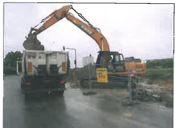
Chargement des terres impactées en semi-remorques et évacuation vers le biocentre OCCITANIS de Graulhet (81)
